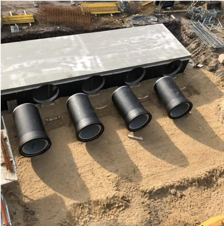
Gruntowy wymiennik ciepła
